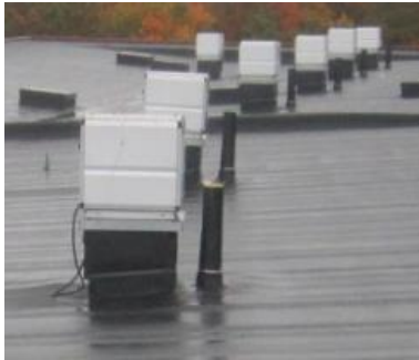
Figur 22: Frånluftfläktar på tak
