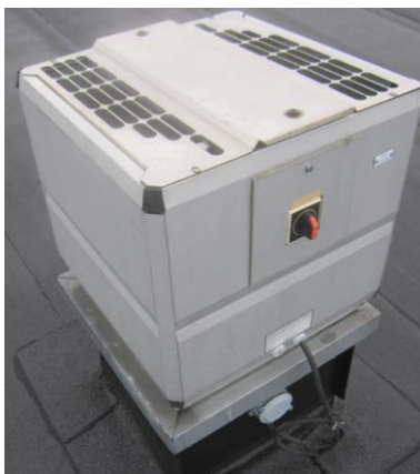
Figur 23: Frånluftfläkt på tak
