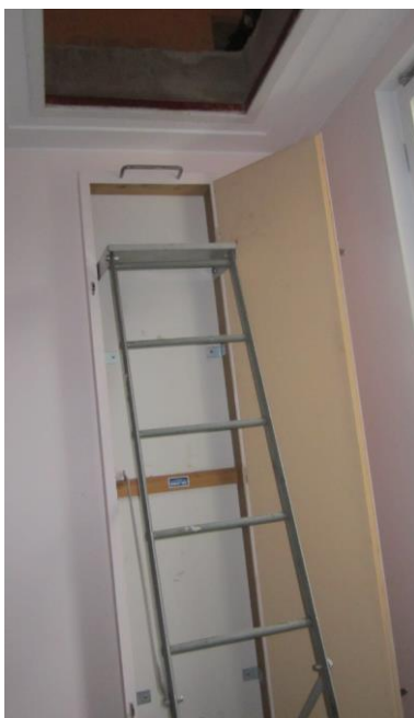
Figur 17: Befintlig stege som går till ett av de sex stycken tilluftaggregaten
