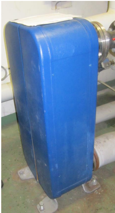
Figur 29: En av dagens två fjärrvärmeväxlare
