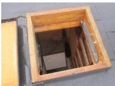
Figur 21: Lucka på tak för att komma åt frånluftfläktarna på taket
